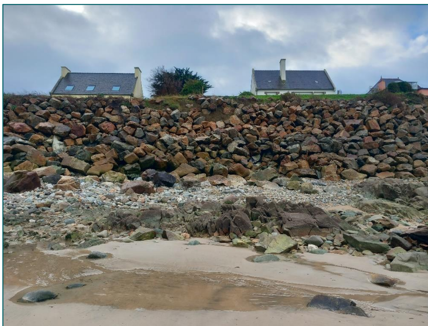
Ouvrages en enrochement présentant des effondrements de blocs au pied des habitations, Moulin de la rive à Locquirec, novembre 2023
